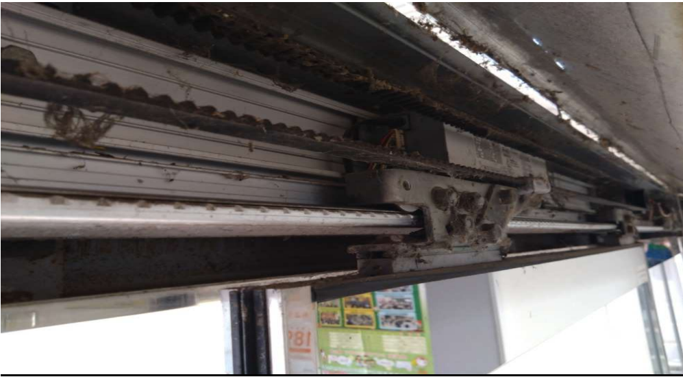
件名：さぬき市辛立文化センター 自動ドア開閉装置（装置取付状態）
