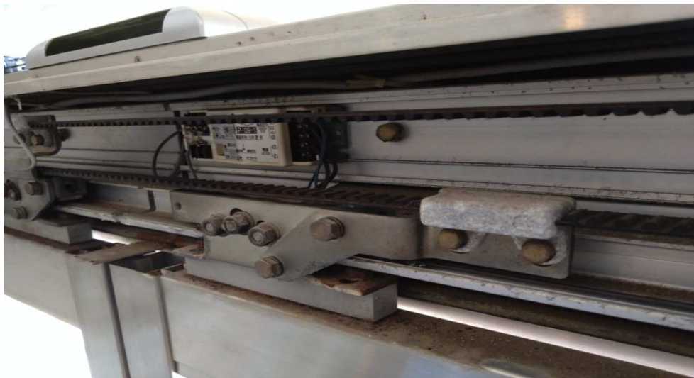
自動ドア開閉装置の様子
