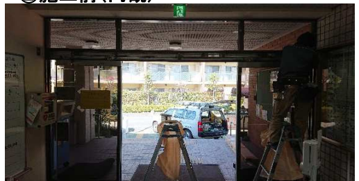
③老朽化自動ドア開閉装置
