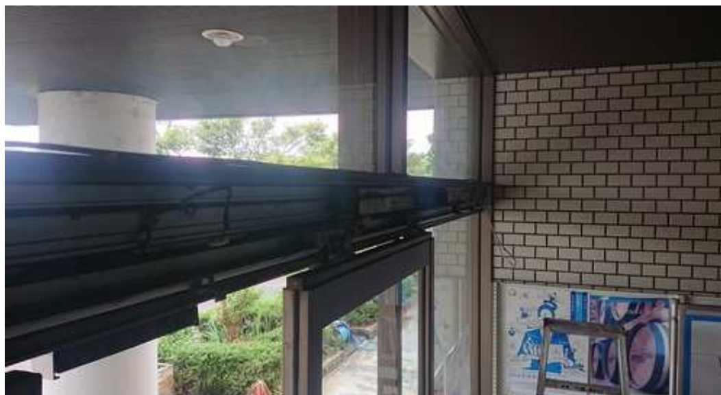
自動ドア開閉装置（内観左側）
