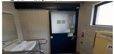
③ 老朽化自動ドア装置
