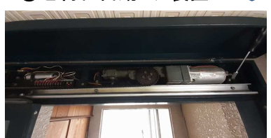
④ 老朽化自動ドア装置
