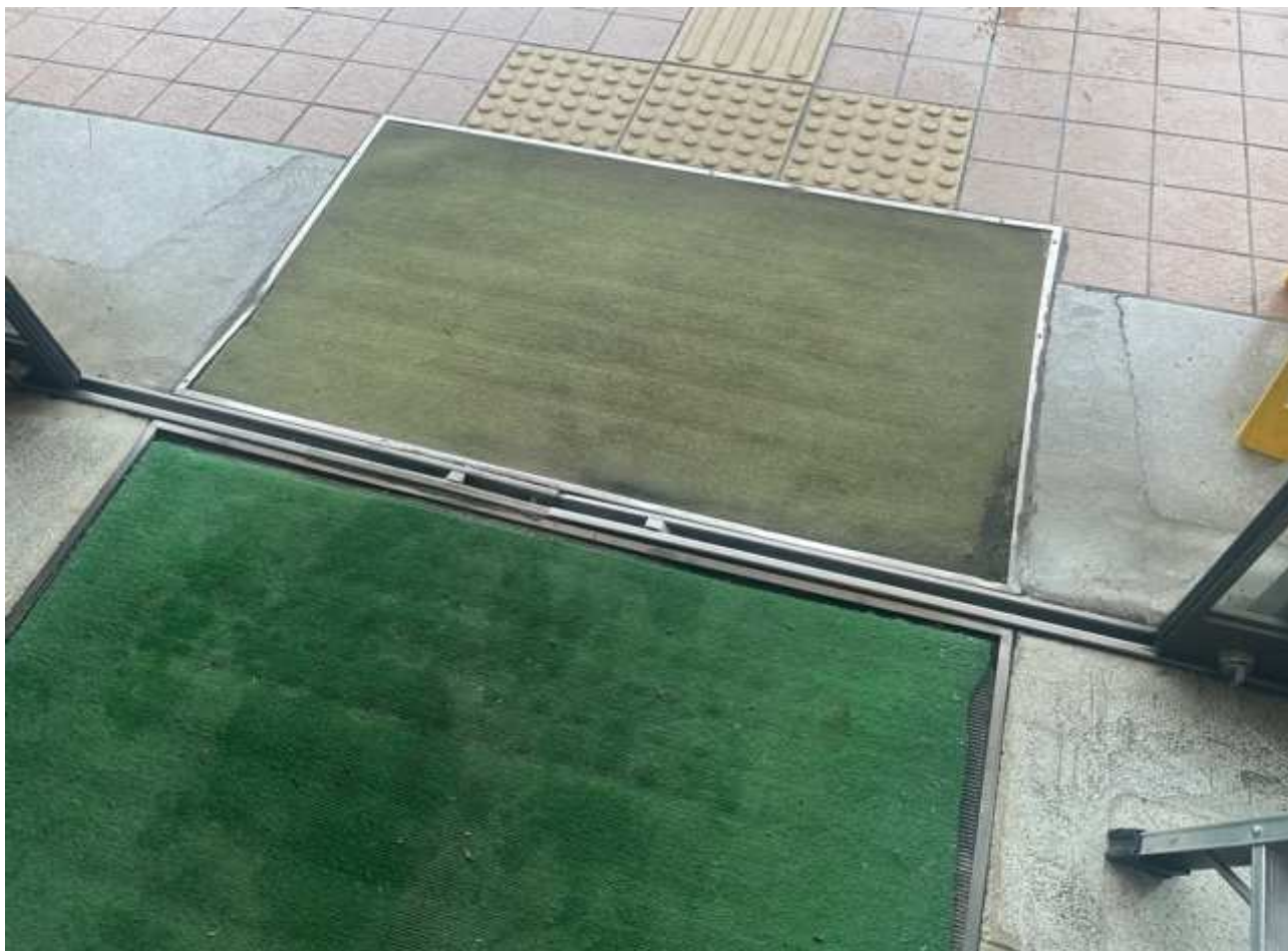
ガイドレールの様子
