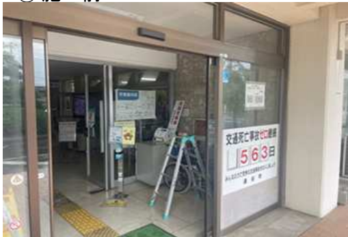
② 老朽化自動ドア開閉装置
