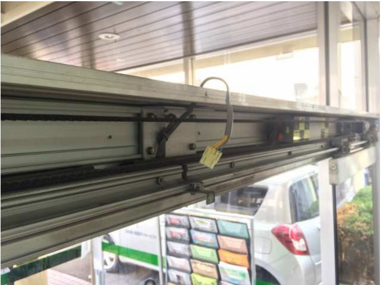
風除室内側の自動ドア装置内部の様子↓
