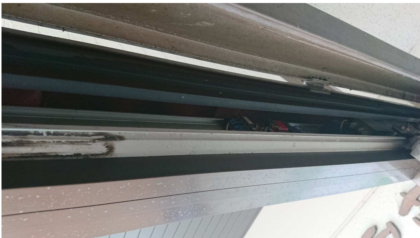
自動ドア内部の様子
