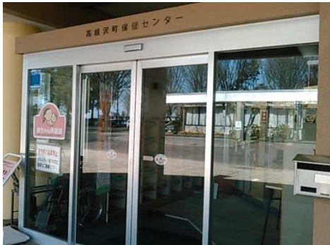
② 老朽化自動ドア装置
