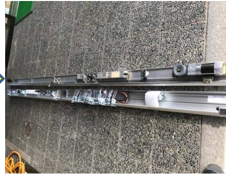
④ 新・旧 自動ドア開閉装置
