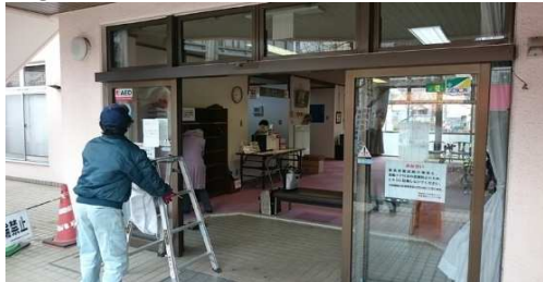
③ 老朽化自動ドア開閉装置
