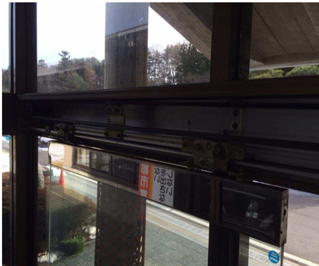
自動ドア装置内部 左側
