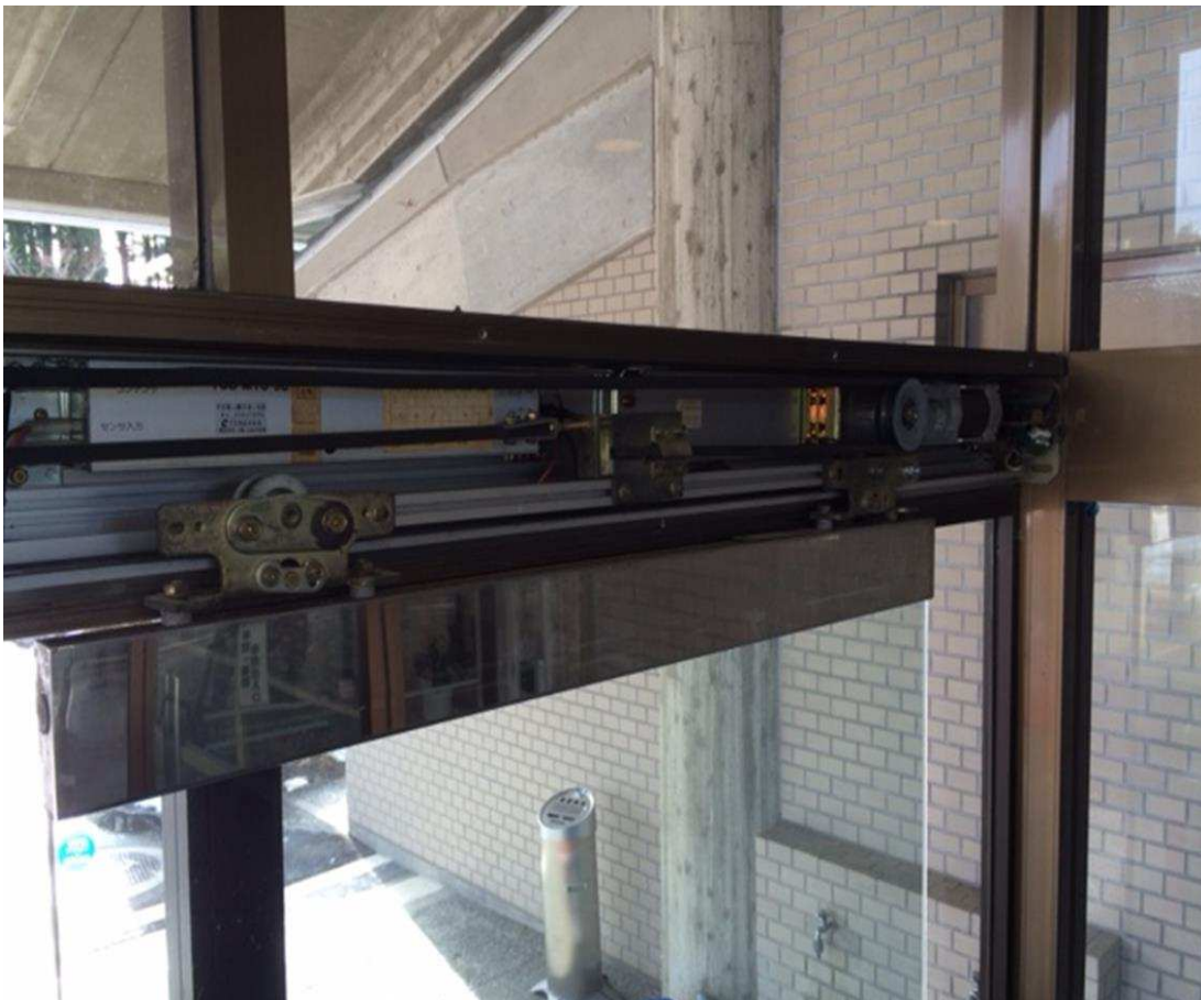
自動ドア装置内部 右側
