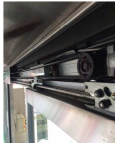
⑤ 老朽化自動ドア装置
