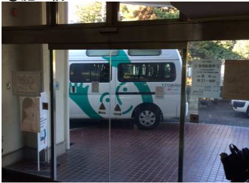
②老朽化自動ドア装置
