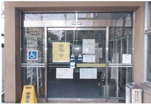
② 老朽化自動ドア装置
