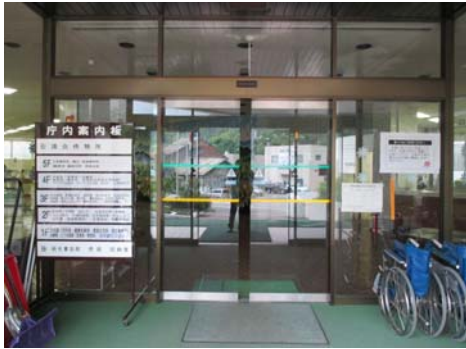
② 老朽化自動ドア装置
