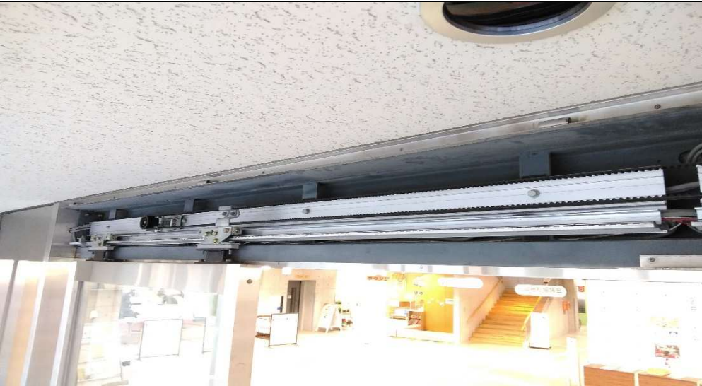
自動ドア開閉装置（装置取付状態）
