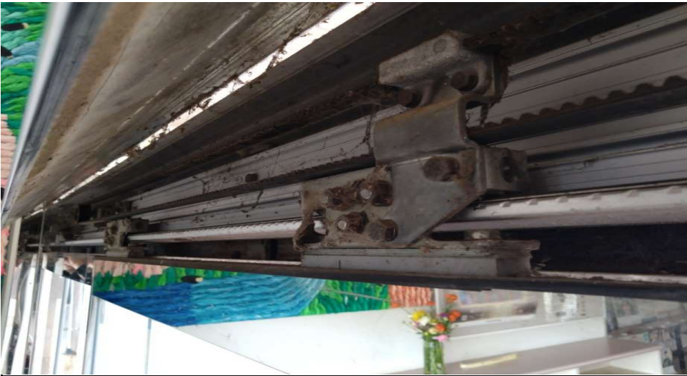
自動ドア開閉装置（装置取付状態）
