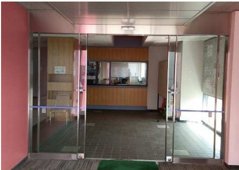
②老朽化自動ドア開閉装置
