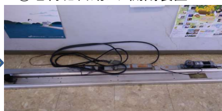
⑤老朽化自動ドア開閉装置
