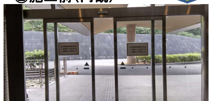
③ 老朽化自動ドア装置
