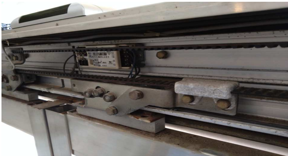
自動ドア開閉装置の様子
