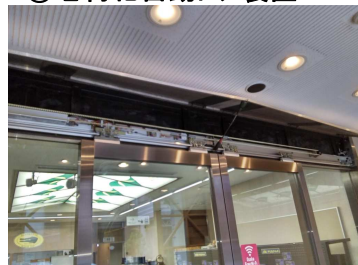
③老朽化自動ドア装置
