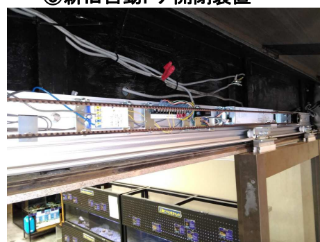
⑥新旧自動ドア開閉装置
