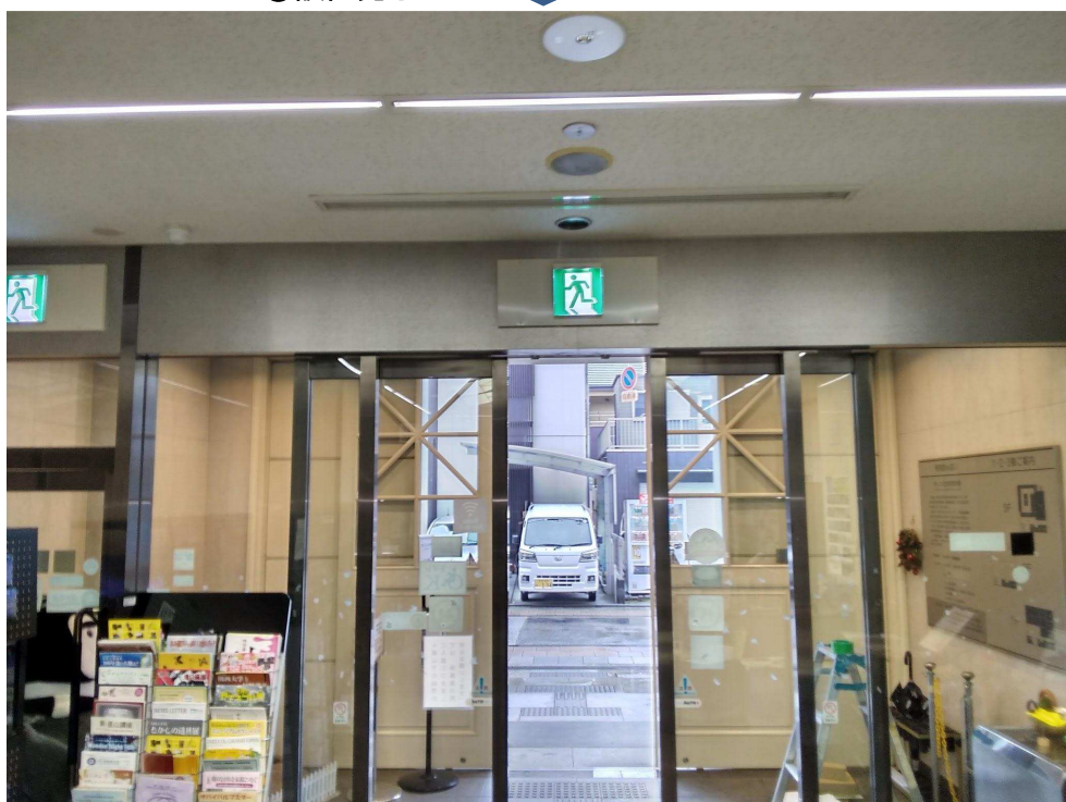
⑨設置完了
