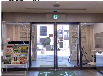
②老朽化自動ドア装置
