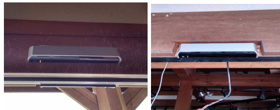
⑦内外起動センサ交換
