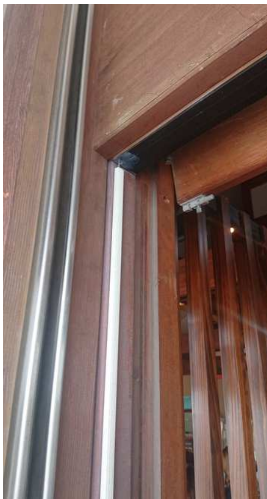
補助光線配線の様子(自動ドア開閉装置との取り合い)
