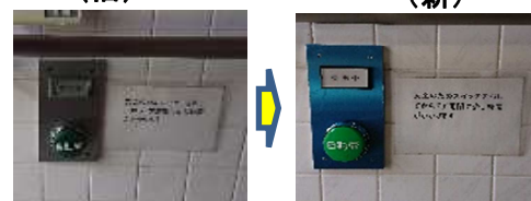
⑦ 内部押しボタンスイッチ (旧) (新)
