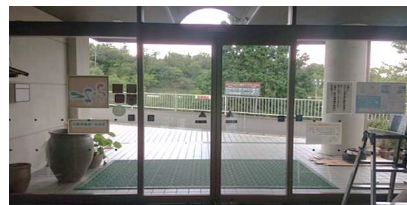
⑦ 自動ドア装置交換後内観
