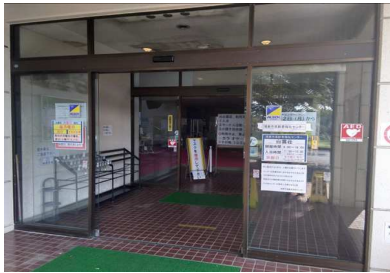
② 老朽化自動ドア装置
