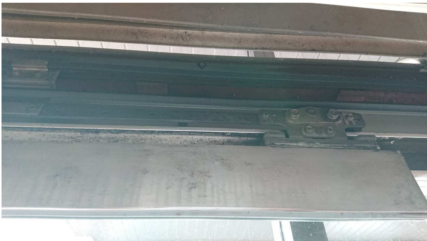
自動ドア内部の様子
