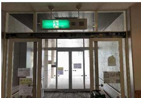
② 老朽化自動ドア装置
