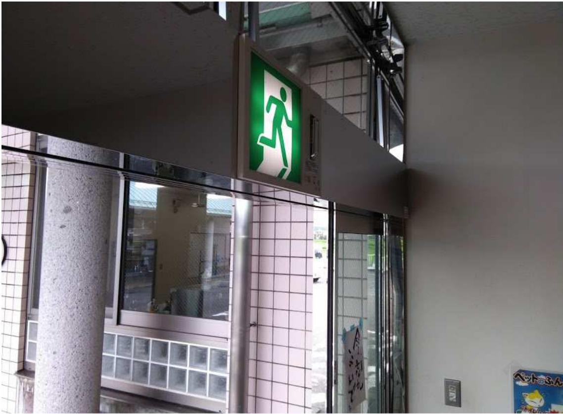
非常灯の様子
