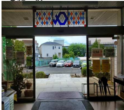
②老朽化自動ドア装置
