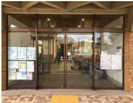
② 施工前(センサー)
