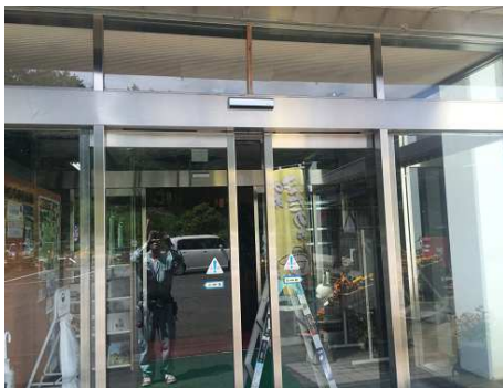
② 老朽化自動ドア装置
