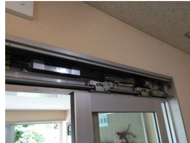
老朽劣化自動ドア装置
